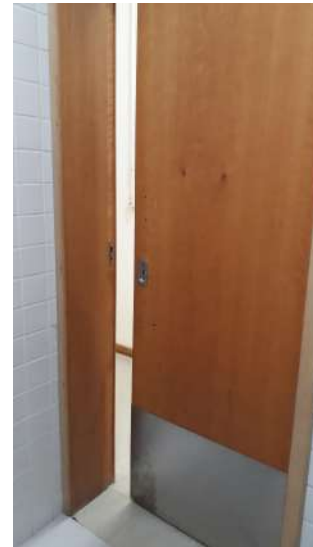
Figura 25: Sanitário com puxador estragado
