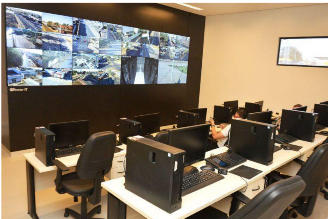
Figura 5 – Sala de videomonitoramento do CIT de Aparecida de Goiânia
