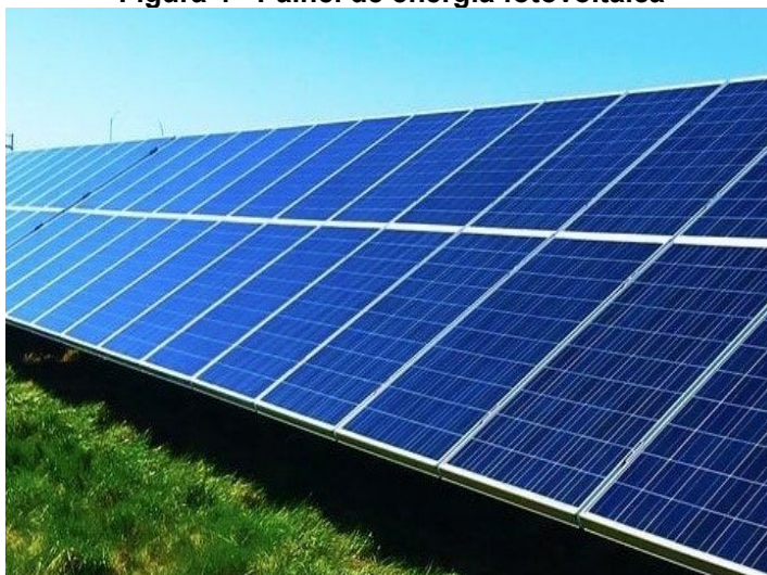
Figura 4 - Painel de energia fotovoltaica
